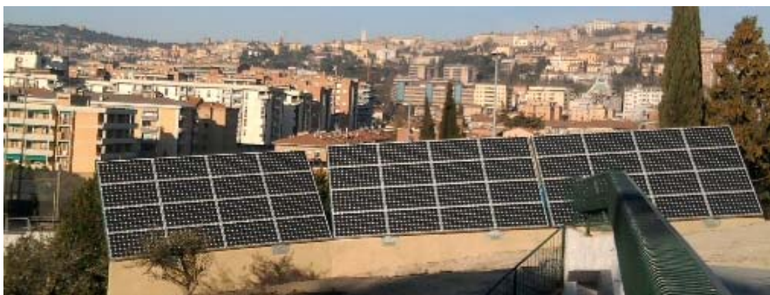
Figura 7 – Immagine dell'impianto oggetto di studio
