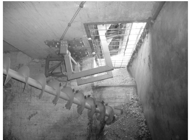
Figura 5: Vista interna del silos di stoccaggio del cippato
