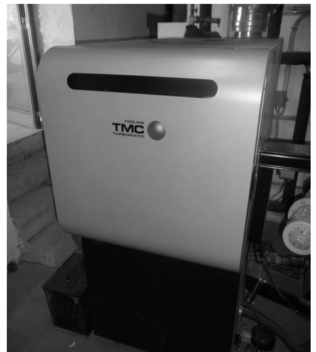
Figura 6: Caldaia a cippato
