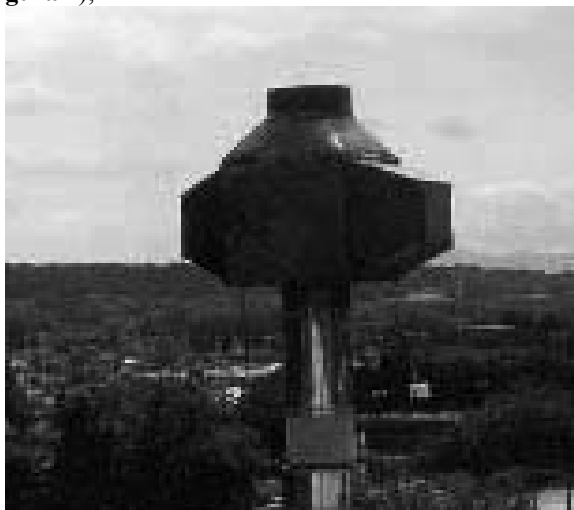
Figura 6: sistema di controllo attivo del rumore allo scarico di gruppo elettrogeno
