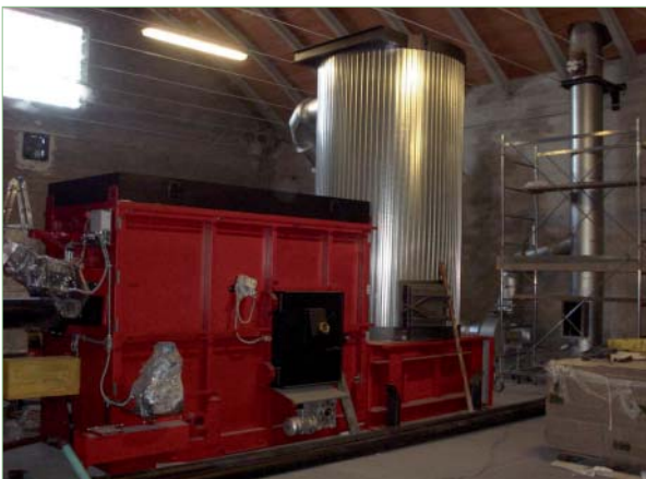
FIGURA 5 - Caldaia ad olio diatermico alimentata a cippato di potature
